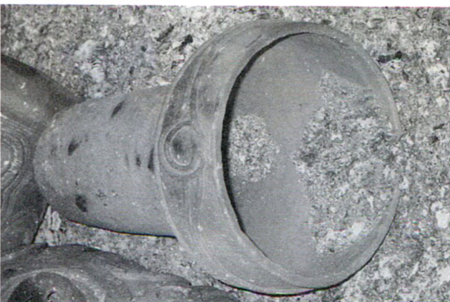
写真7-7 内面の灰の堆積状況
